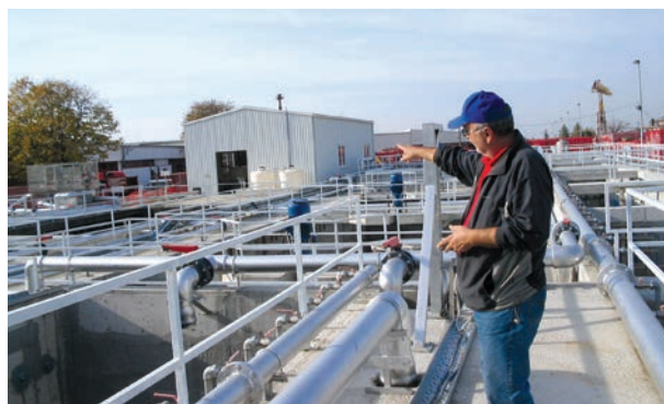
POSTROJENJE ZA PRERADU OTPADNIH VODA
